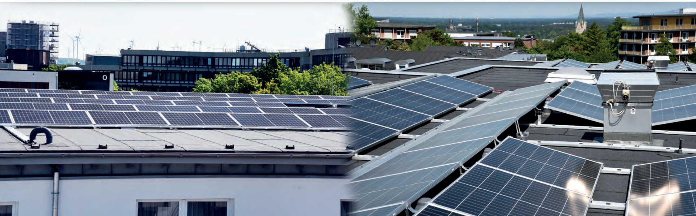
Dachsanierung im Mersinweg – Hauptverwaltung, Amt für Ausbildungsförderung und Studentisches Wohnen – mit der Sanierung erhielt auch dieser Gebäudekomplex auf den Dächern eine Photovoltaikanlage.
